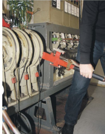
Noch immer werden Weichen und Signale am Sülldorfer S-Bahnhof händisch bedient.
